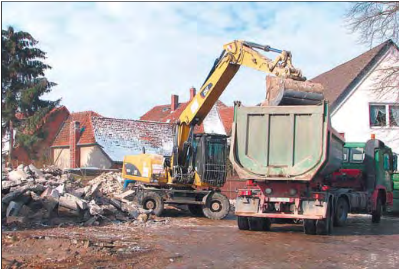
Nur noch ein Schutthaufen: Der Abriss des alten Gewerbebaus neben dem Lindenplatz ist weit vorangeschritten. Ein Bagger lädt die Reste auf. Zottl
