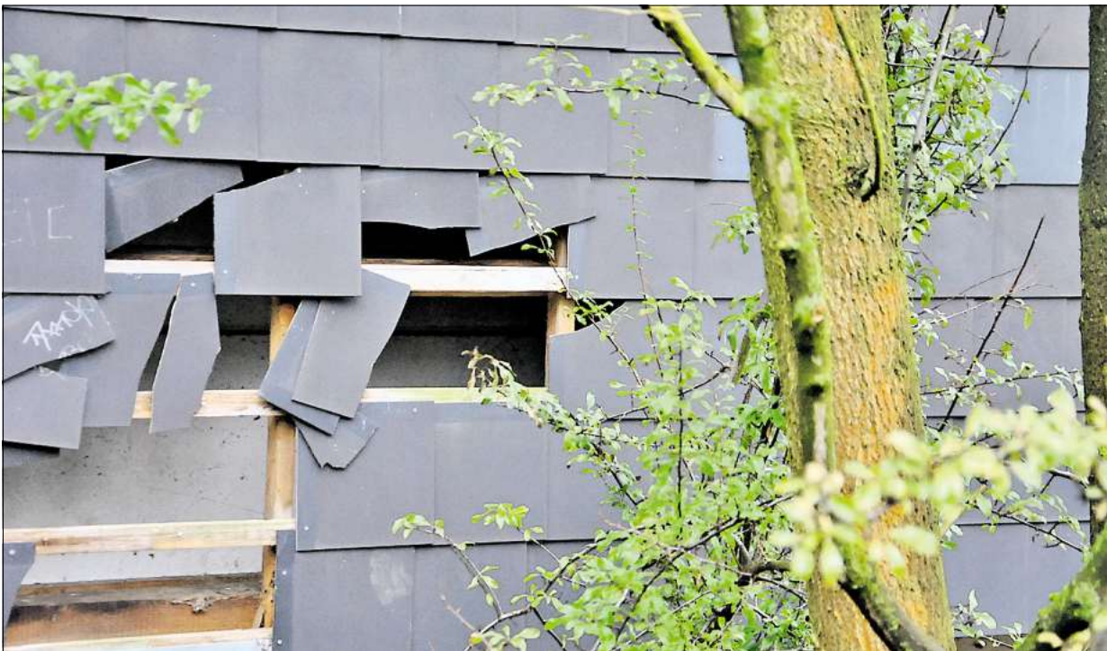
Marode: Die Eternitplatten an der Fassade der Ballspielhalle werden entfernt. Das Gebäude bekommt einen neuen Anstrich nach dem Farbkonzept des KGS. Vogt
