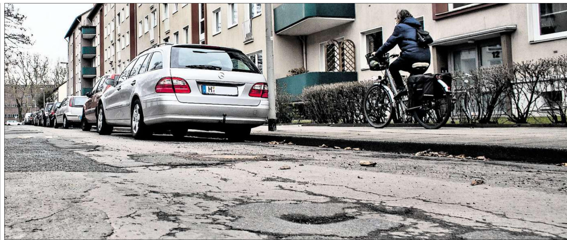
„Keine zusätzlichen Belastungen für die Autofahrer“: Die Beseitigung von Schlaglöchern will Niedersachsens Verkehrsminister Olaf Lies über die neue Lastwagenmaut finanzieren. von Dittfurth
