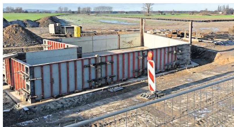
So sieht die Baustelle zurzeit im Süden zwischen Arnum und Pattensen aus.
