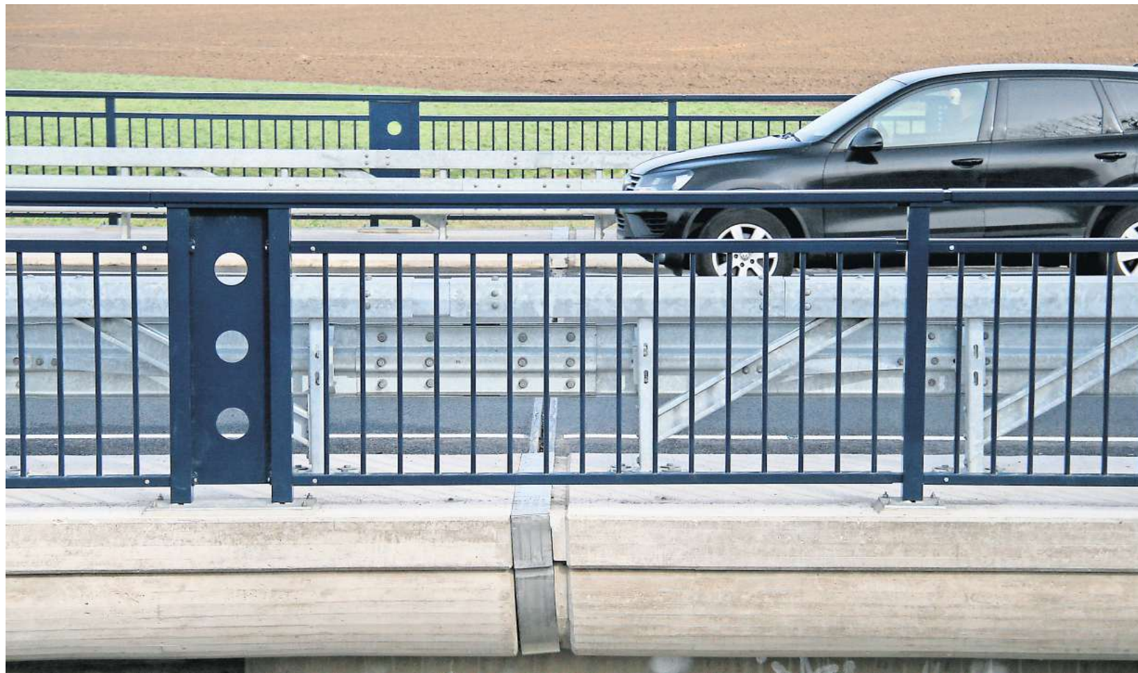
Wenn Fahrzeuge über diese Dehnungsfuge auf einer Brücke bei Arnum rollen, ist ein klackendes Geräusch zu hören.
